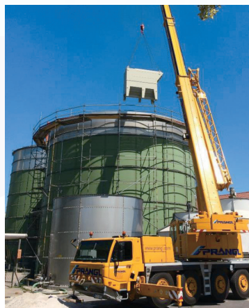
BIOPAQ®ICXリアクター内部部品 モジュール据付状況
