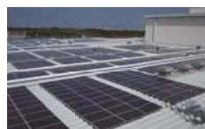
13 大阪府・堺市 460kW 1,770枚 屋根設置 2013年9月系統連系
