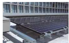
10 I-STEP 湘南 7.2kW 屋根設置 2015年3月系統連系
