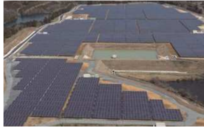
2 岡山県・奈義町 14,375kW 45,780枚 2017年3月系統連系 ⚡14MW
